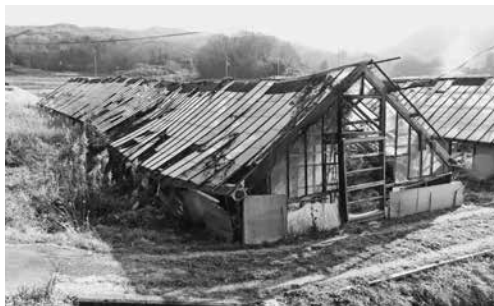
荒廃した農業用施設
