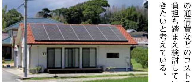
太陽光発電設備を設置している集会所
