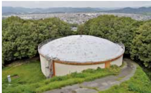
桜が丘地区の配水池
