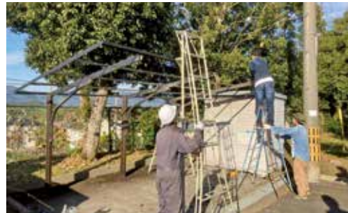
破損した資源化物集積所の屋根
