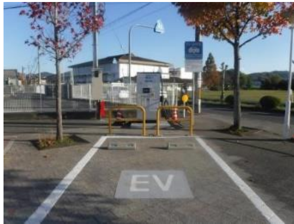
図 2-19 桜が丘いきいき交流センターの急速充電器
