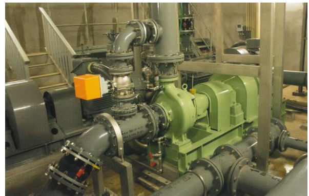
図 8-6 東部地域広域水道企業団施設内 (山梨県大月市)
