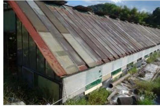
ガラスハウスの外観 (裾部分に補強の跡が多く見られた)
