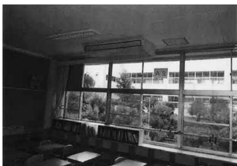
エアコンが設置された教室
