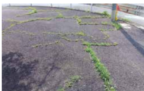
修理が必要な歩道
