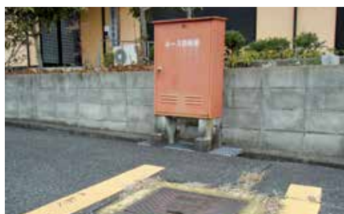
消火栓とホース格納箱
