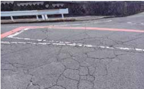
クラックが発生している山陽団地の道路
