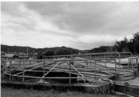
老朽化した桜が丘東浄化センター
