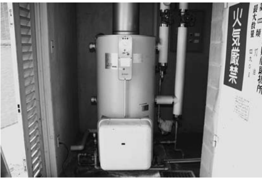
修繕予定の山陽児童館のボイラー
