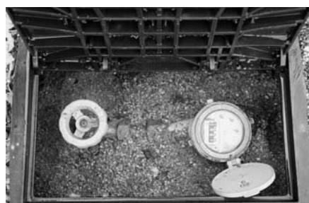
水道メーター
