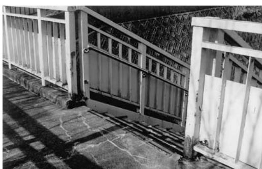
歩道橋の老朽化した部分（山陽）
