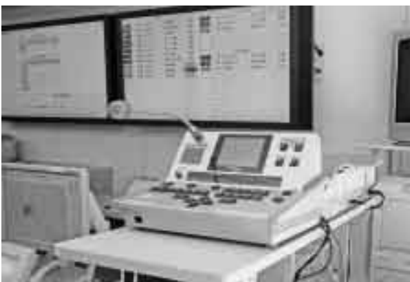
防災無線装置（赤磐市消防本部）
