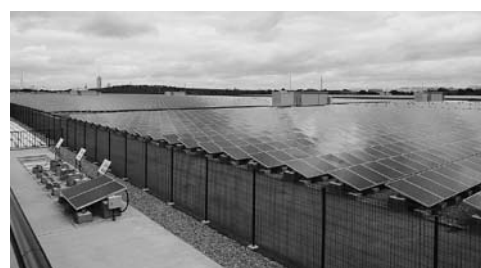
メガソーラー施設（大阪府堺市）
