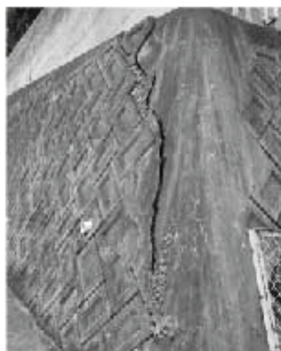
ヒビ割れとブロック壁壁（山陽4丁目）
