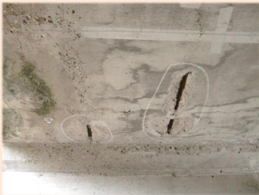
床版部の鉄筋露出
