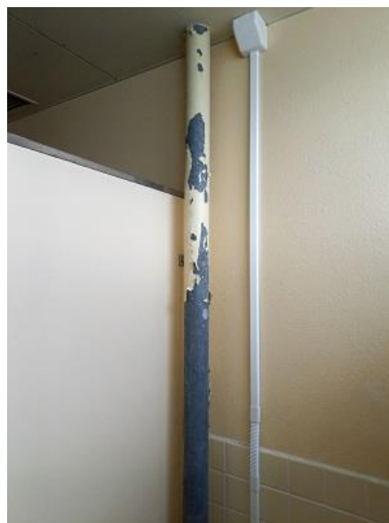
写真6 同トイレ内配管の塗装剥離
