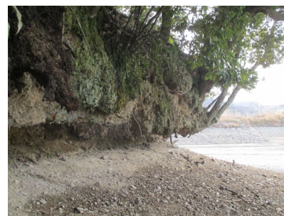
▲ 工程前 墳丘底部損壞部分
