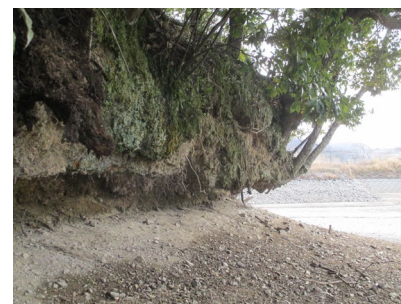
▲ 工程前 坟丘底部损坏部分
