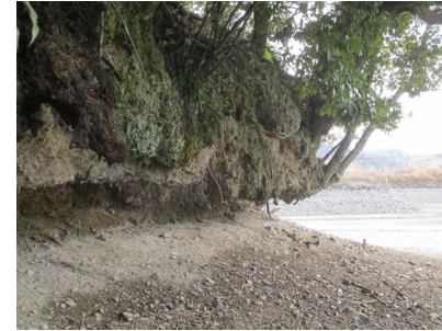
▲ 공사 전 분구 기슭이 손상된 곳
