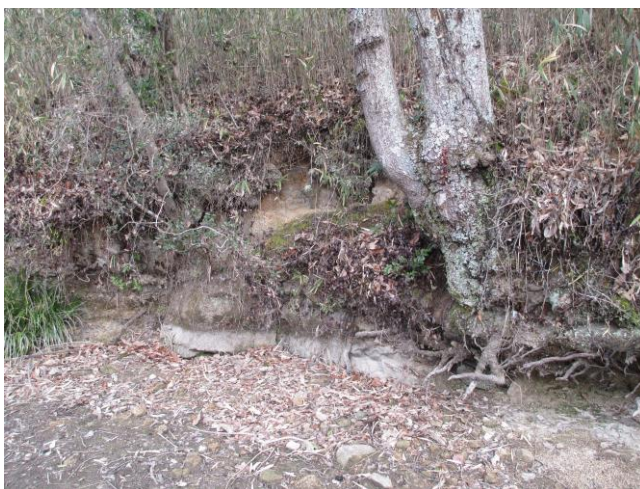
墳丘の土が崩落しそうなところ（後円部）
