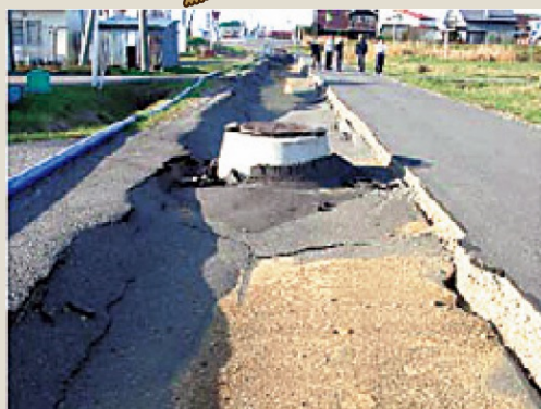
液状化によって浮き上がったマンホール
